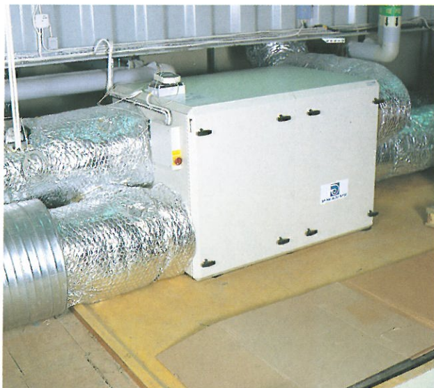
Det nya GOLD-aggregatet installerat hos Fazer, Lidköping
