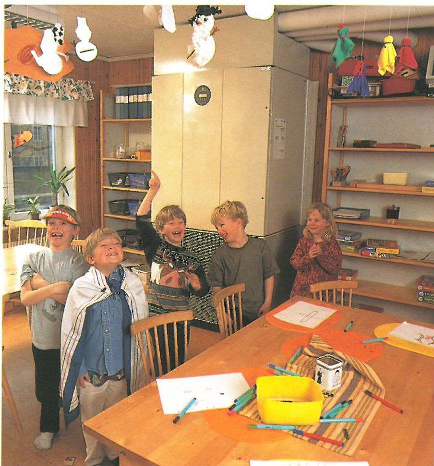
Compact Air installerat på ett daghem
