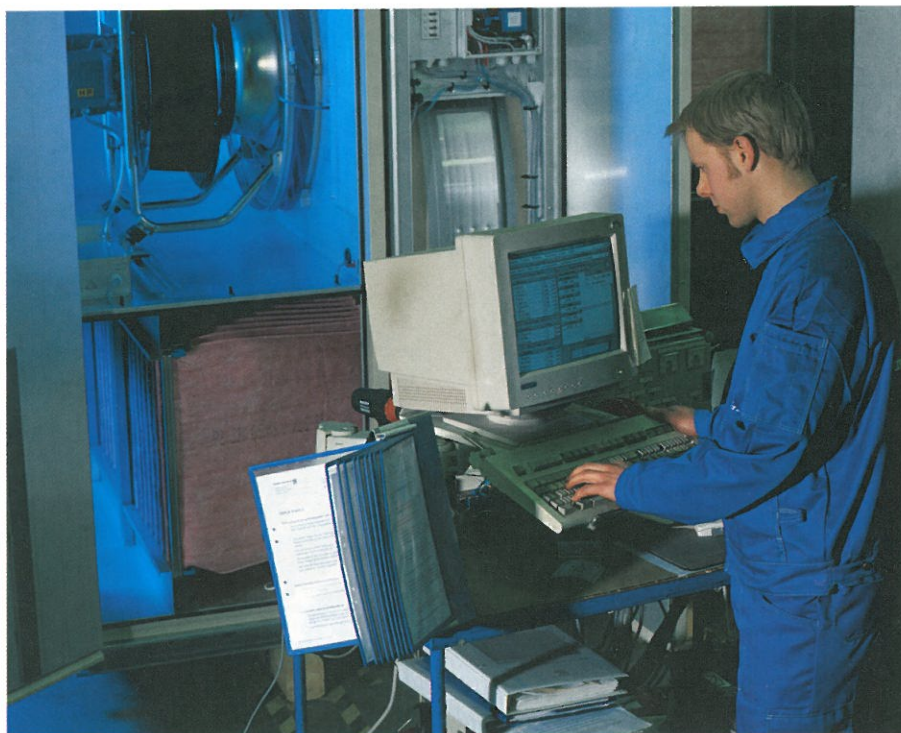
Datoriserad slutkontroll av PM-LUFT:s GOLD-aggregat.
