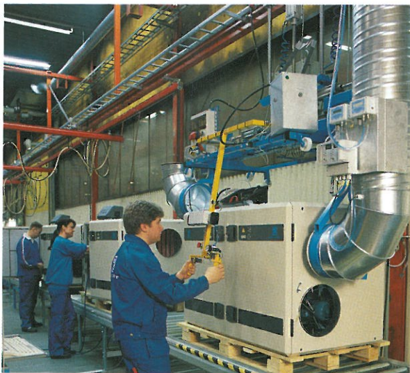
Test och inkörningskontroll av de nya GOLD-aggregaten.
